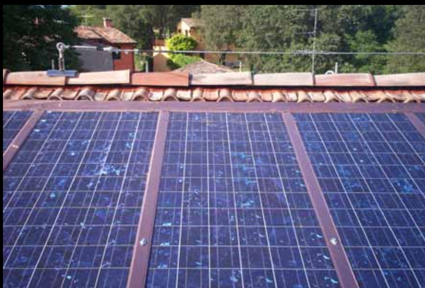
Impianto fotovoltaico da 4.5KWp totalmente integrato allacciato novembre 2009
